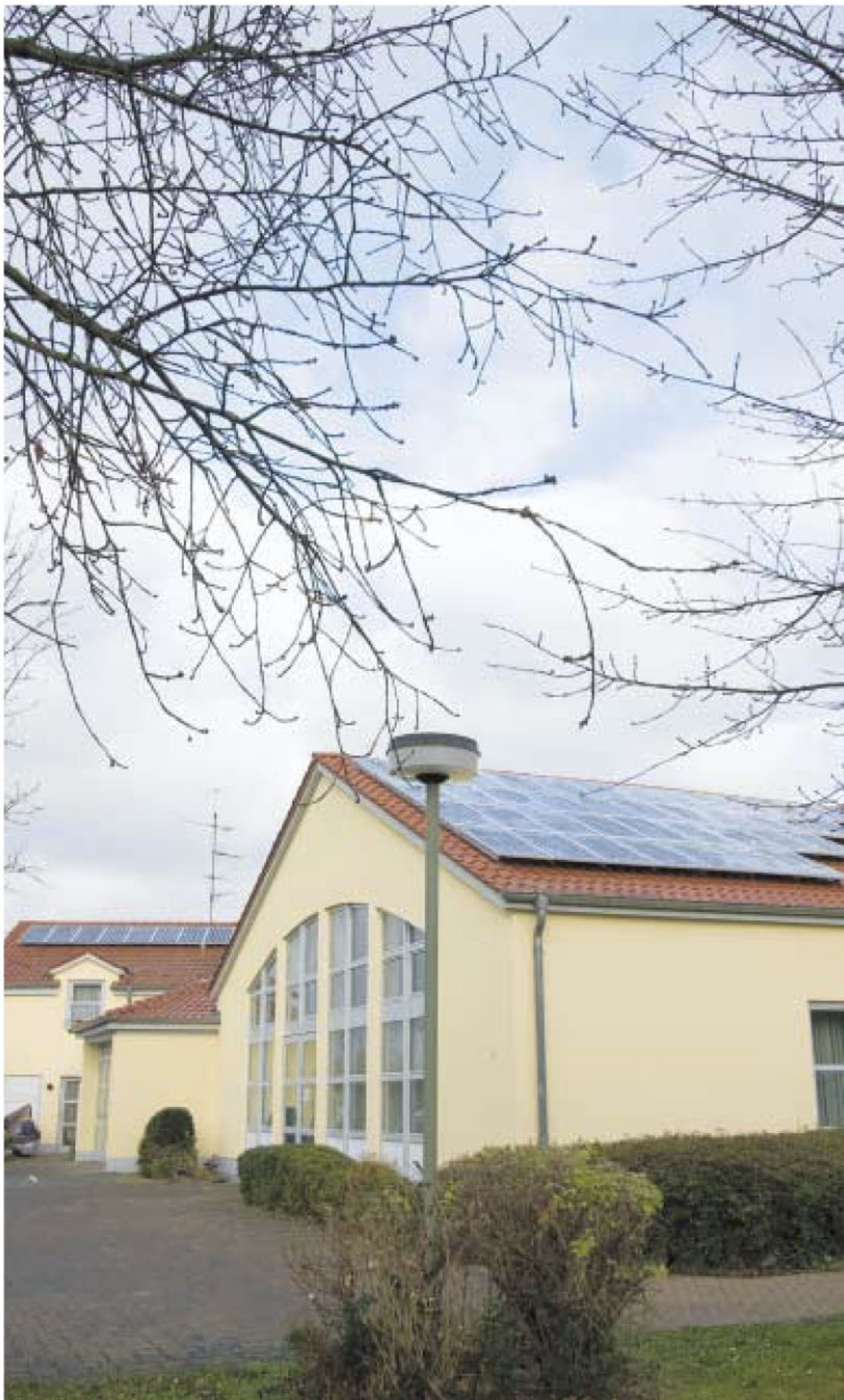
Die Anlage ist installiert: Vom Dach der Halle soll bald Energie gewonnen werden. Foto: pa/Carsten Selak
